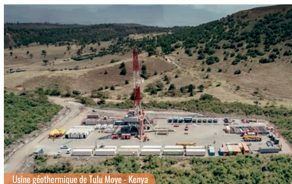
Usine géothermique de Tulu Moye - Kenya
